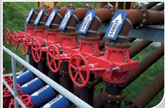
安装在DONG能源公司的Flowrox管夹阀
